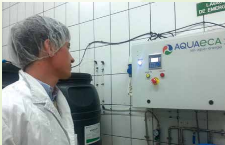
Установленное оборудование в Испании.
